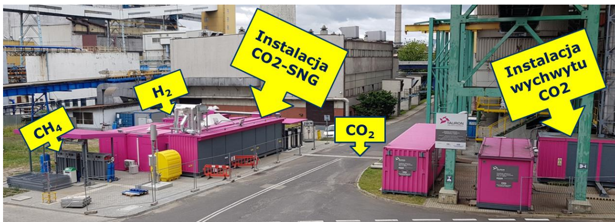
Rys. 3.18 Widok instalacji pilotowych do pozyskiwania CO 2 oraz wytwarzania CNG – Elektrownia Łaziska TAURON Wytwarzanie S.A.
