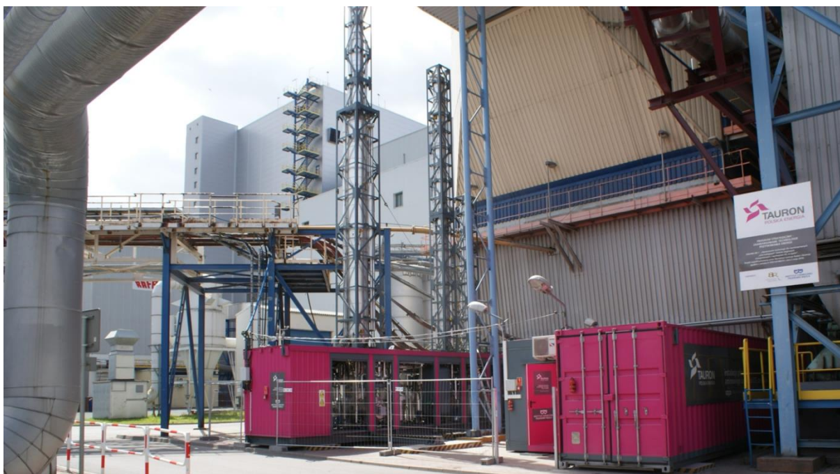
Rys. 2.1 Instalacja Pilotowa podczas badań w Elektrowni Jaworzno II – TAURON Wytwarzanie S.A.
