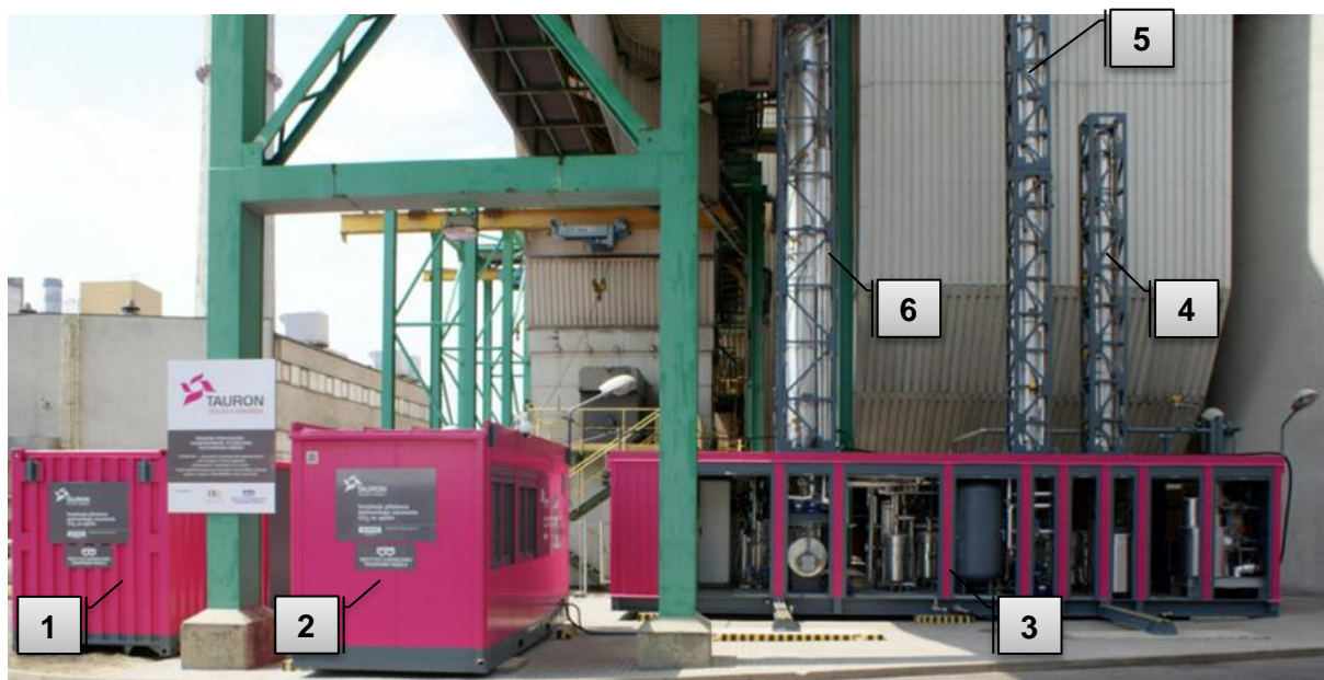
Rys. 4.1 Instalacja Pilotowa podczas badań w Elektrowni Łaziska – TAURON Wytwarzanie S.A. (1 – Kontener Magazynowy, 2 – Kontener Nadzoru, 3 – Kontener Technologiczny, 4 – Kolumna odsiarczania, 5 – Absorber, 6 – Desorber)
